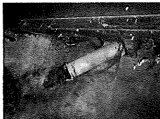
Conduit dans cave 1
